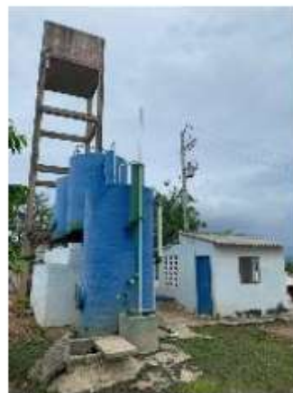
Foto 10. Planta de Tratamiento de Agua Potable (PTAP) Compacta
